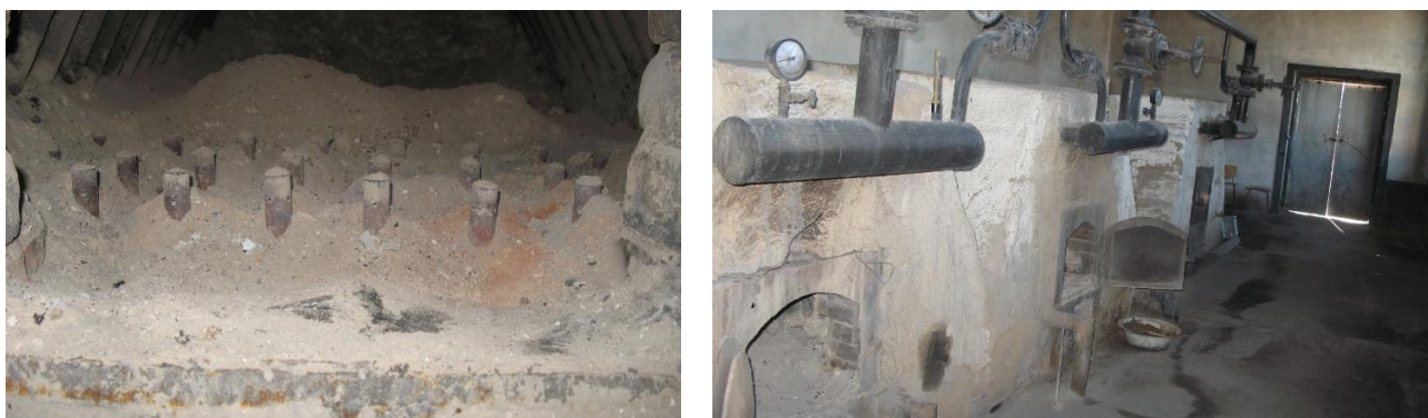
а) б) Рисунок 3 – Общий вид внутри топки (а) и котельной (б)
